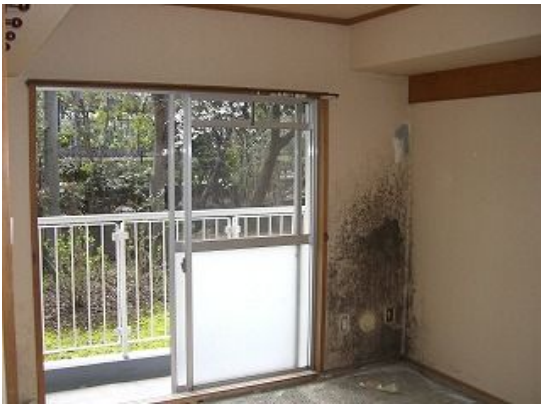
着工前(クロス面カビあり)
